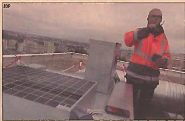
Les capteurs ont été installés par la société Gtelio, basée à Angers.
